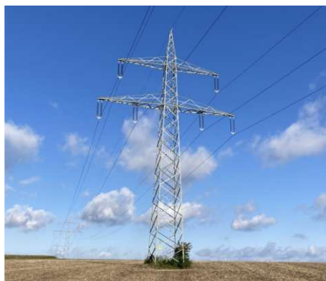
Höchstspannung (220kV) TenneT
