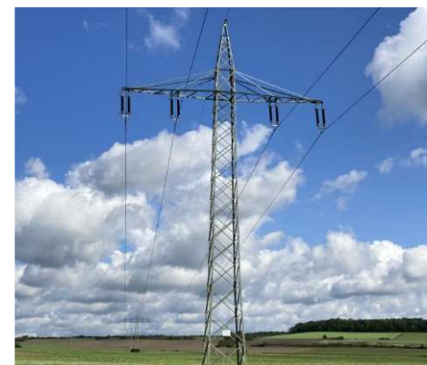
Hochspannung (110kV) Deutsche Bahn
