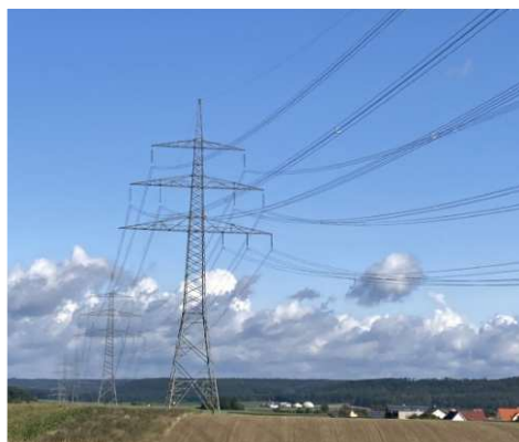
Höchstspannung (380kV) TenneT
